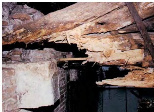
Fig. 9a e 9b: Cedimento dell'appoggio di una testa di una grande capriata all'Arsenale di Venezia. Il danno è rimasto localizzato perché la struttura è stata concepita spazialmente. In altre parole la struttura è "robusta".
