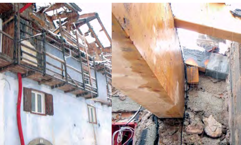
Fig. 4a e 4b: A provocare l'incendio di questo tetto di legno è stata l'inconcepibile disattenzione di aver infilato una trave di legno nella canna fumaria!
