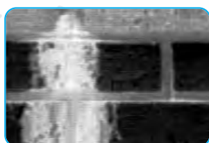
Brucciatura causata da una soluzione troppo concentrata usata per pulire un muro non sufficientemente bagnato; l'acido reagisce con malta e mattoni portando in superficie vari sali.
