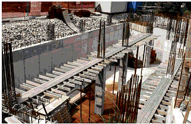
Bloccato Il cantiere di via Bergamine a San Benedetto di Lugana finito nel mirino dei giudici amministrativi
